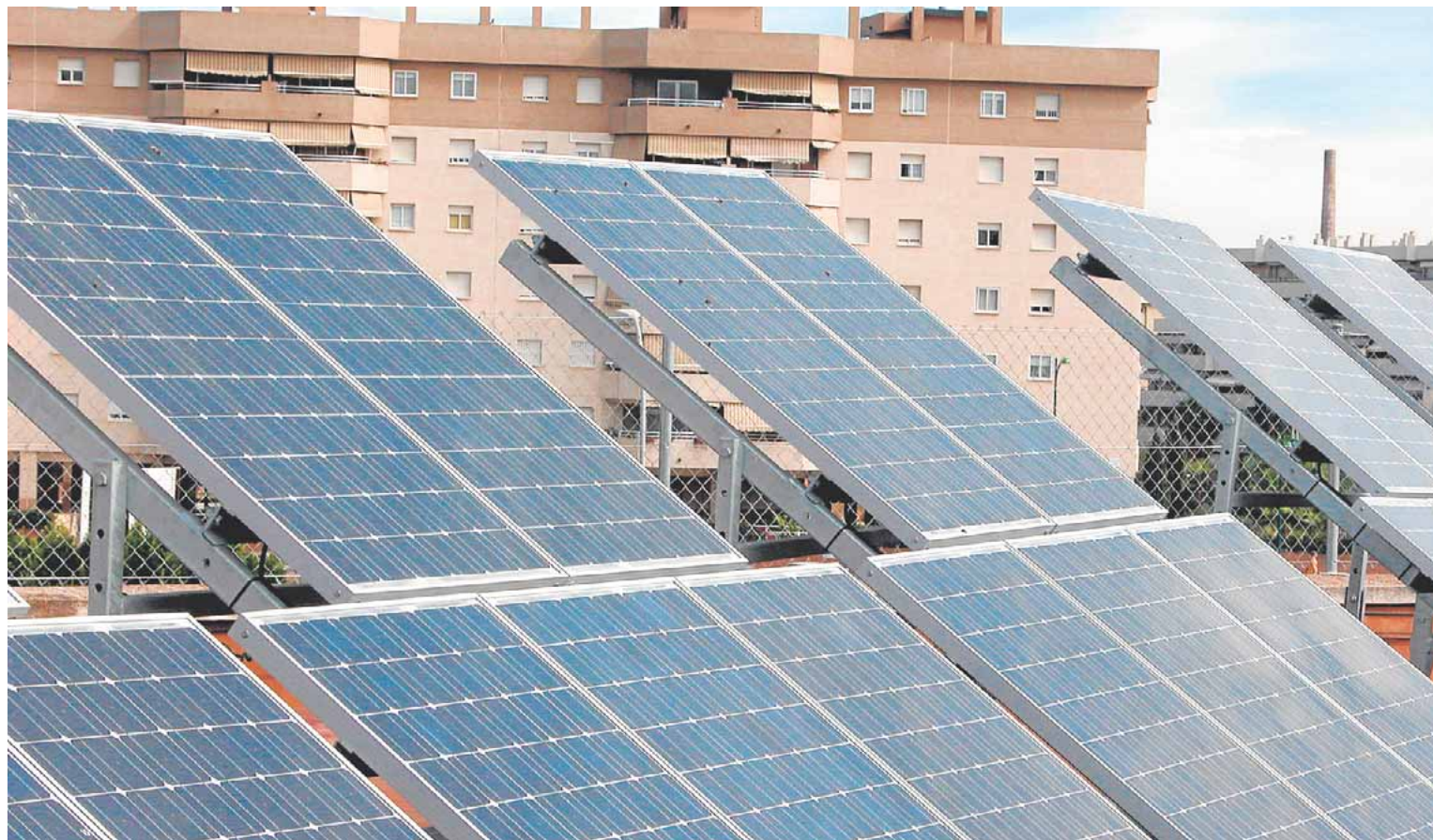
Placas solares sobre el instituto Mare Nostrum, un sistema que ya usan 17.000 consumidores en la provincia de Málaga. sUR
