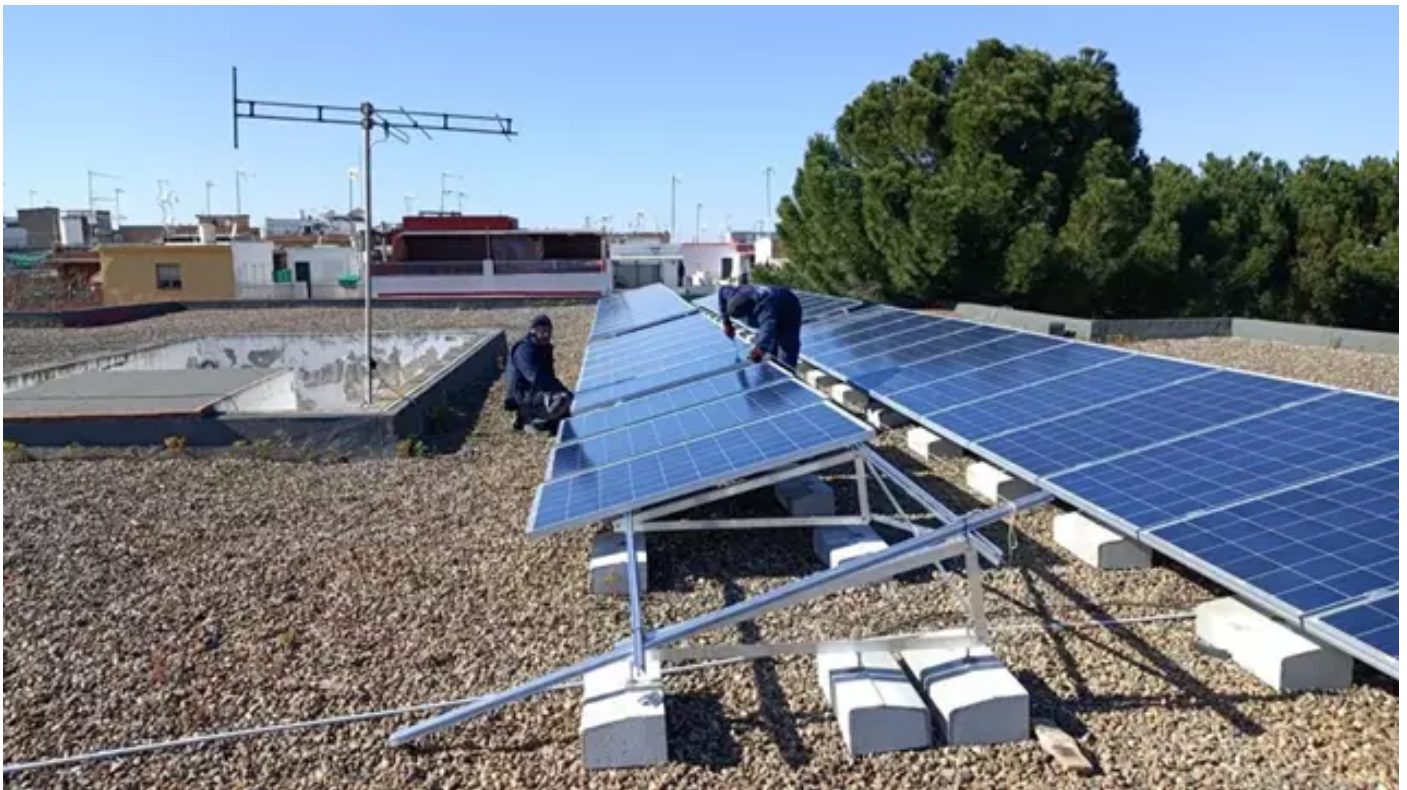
Imagen de una instalación de placas solares. - JUNTA DE ANDALUCÍA
